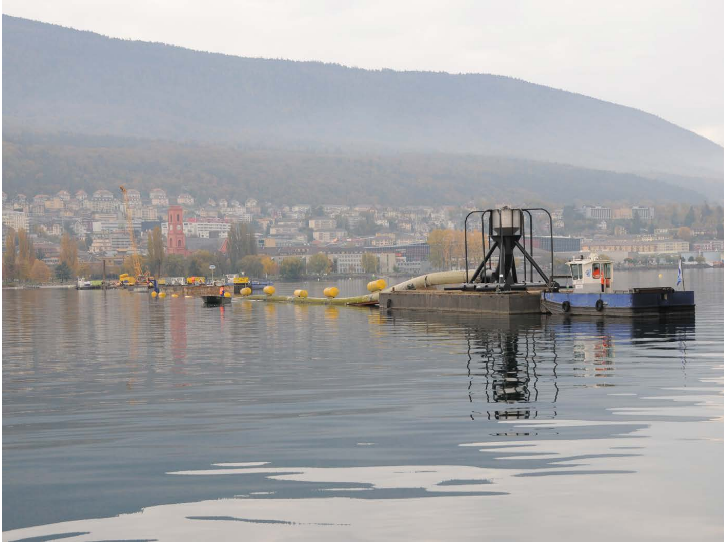
Conduite sous-lacustre pour le rafraîchissement écologique du bâtiment (photo Viteos)
