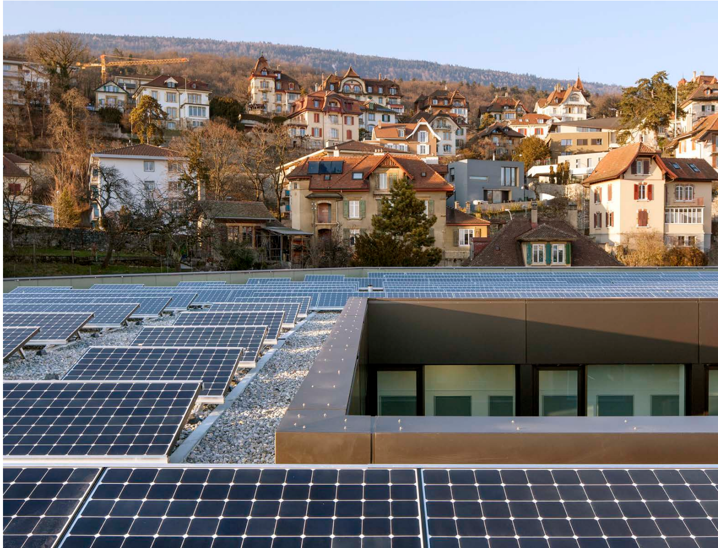
Centrale solaire en toiture (photo Y. André)
